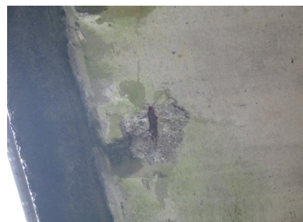
写真3 床版からの鉄筋の露出
