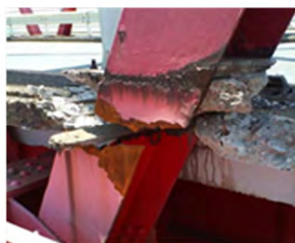
(a) 下路トラス橋・斜材の破断
