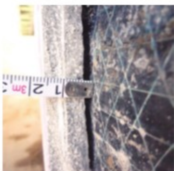
図-1 FRP シートの浮き
