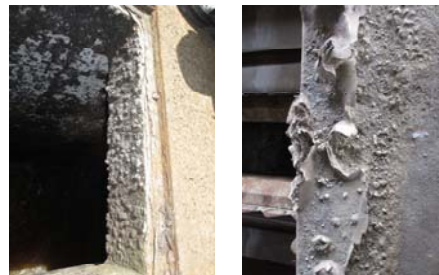
写真1 硫酸劣化が進行している施設
