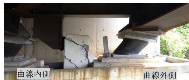
写真-2 A1 橋台曲線外側の変位拘束構造の損傷状況
