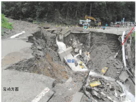
写真6 宮崎県西米良村の道路損壊 (宮崎グループ撮影)
