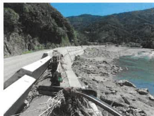
写真5 球磨村の道路損壊 （7月18日、熊本大学椋木撮影）
