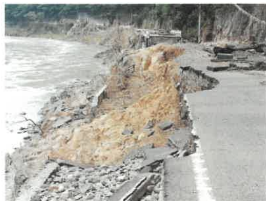
写真4 坂本町の道路損壊 （7月18日、熊本大学椋木撮影）
