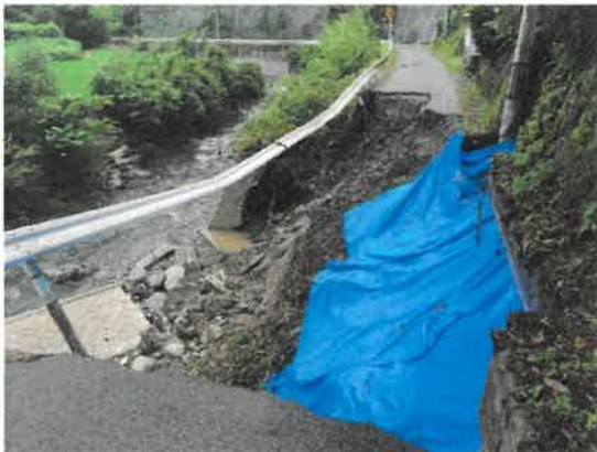
写真10 兼用護岸道路の洗堀に伴う路体崩壊 (福岡大学村上撮影)
