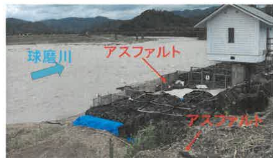
写真7 堤防決壊箇所(右岸56k400付近) (熊本高専脇中撮影)
