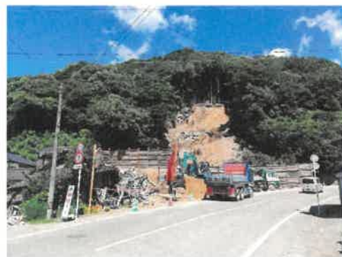
写真1 応急復旧状況（8月30日、熊大椋木撮影）
