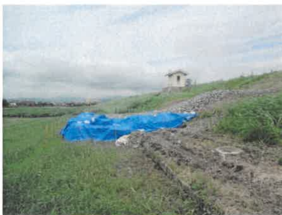
写真11 筑後川39k600右岸付近のパイピング箇所の状況（7月11日、九州大学石蔵撮影）
