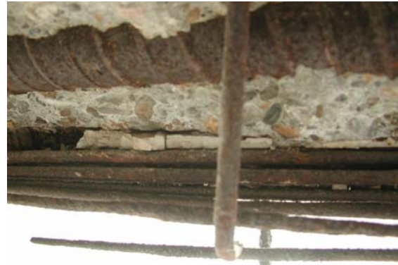
写真 2 PC 鋼材の破断
