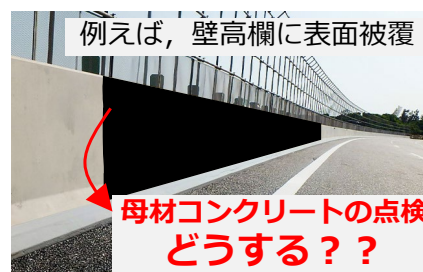
図-1 着色系樹脂被覆による維持管理性能の低下
